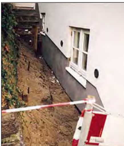
Treppe und Außenwand vor der Sanierung
